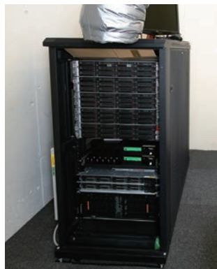
ネイキッドのサーバーラーム。Ultrastar® Data60とレンダリングサーバが、ひとつのラックにコンパクトに収められている
